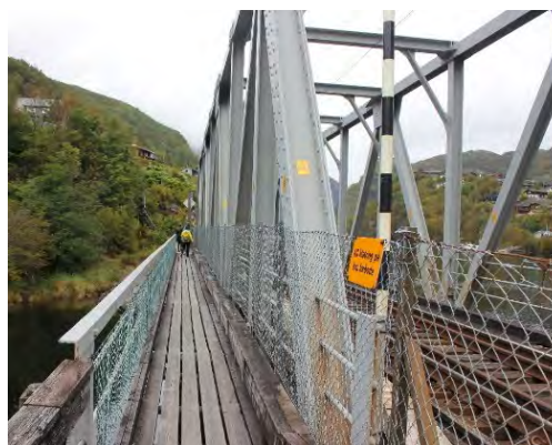
Figur 6-10. Detalj av brua med fotgjengarovergang av nyare dato enn sjølve hovedkonstruksjonen. (Kjelde: Henning Larsen)
